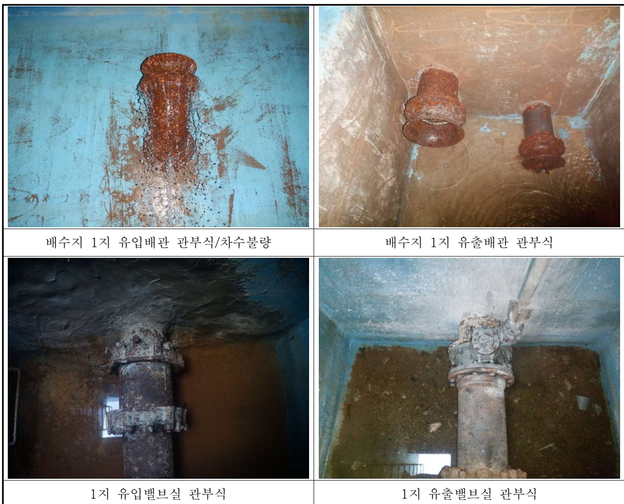
【사진 3.6】 기전설비 손상사진
