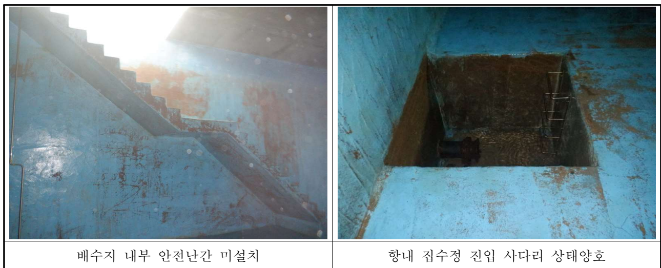
【사진 3.7】 안전시설(점검로) 손상사진
